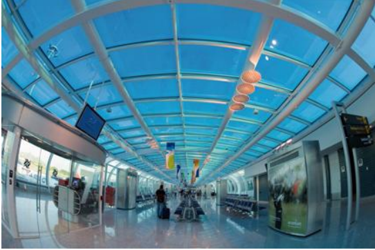
Brasil: TROX difusores do redemoinho distribuem ar fresco para os salões e corredores do Aeroporto Santos Dumont do Rio de Janeiro.
